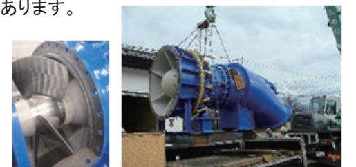
「東町・東新町公民館小水力発電所」 S形チューブラ水車
